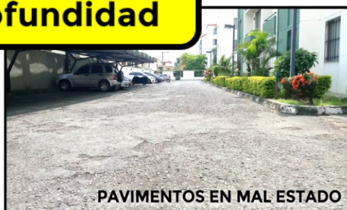
PERDIDA DE CAPA DE RODADURA
